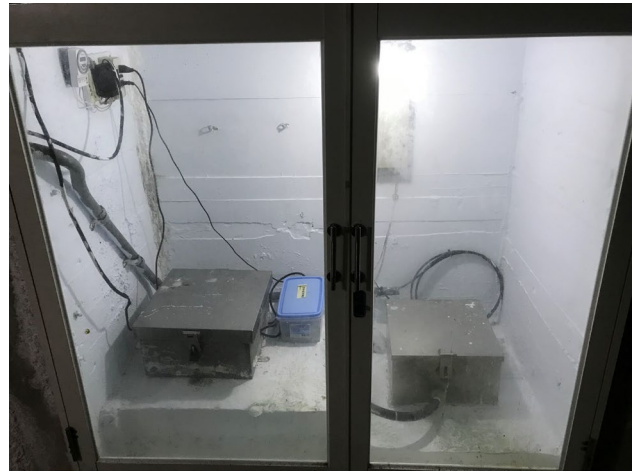
圖 3.1.12 壩基廊道地震儀現況照片
