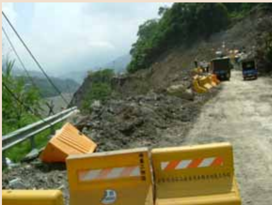
台21線108K上邊坡土石崩塌，下邊坡路基流失
