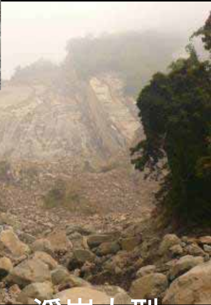
岩層破碎、溪岸大型崩場
