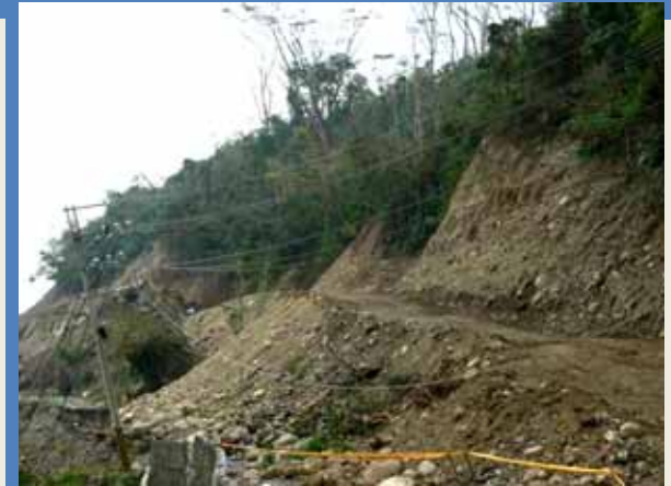
聯外道路路基滑落溪谷
