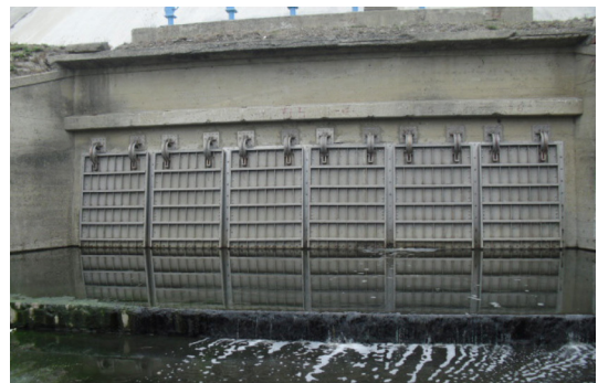
圖 1 自動閘門（曾文溪下游西港堤防 5 號）
