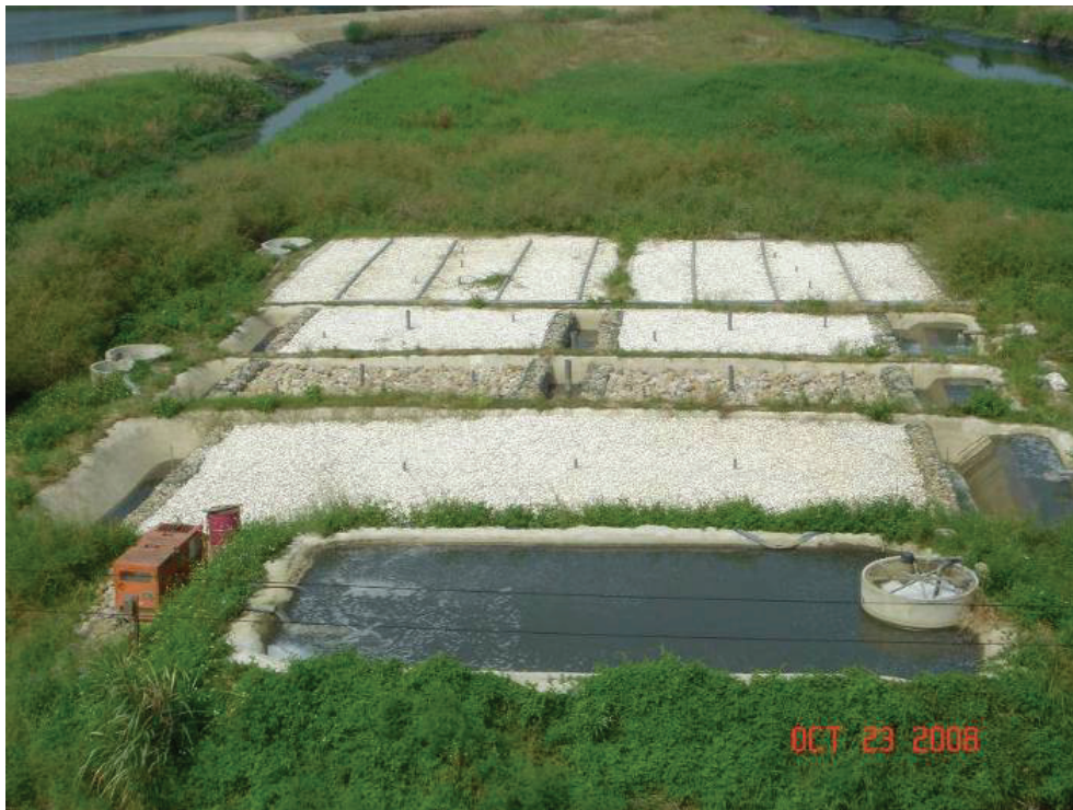
圖 2 二重疏洪道牡蠣殼礫間接觸模場現地照片
